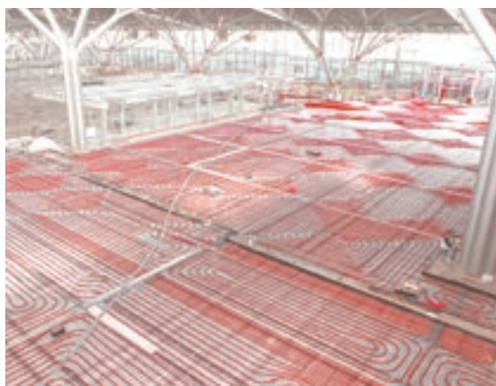
Sistemi di riscaldamento/raffrescamento radiante: soluzioni innovative per ogni tipo di applicazione
